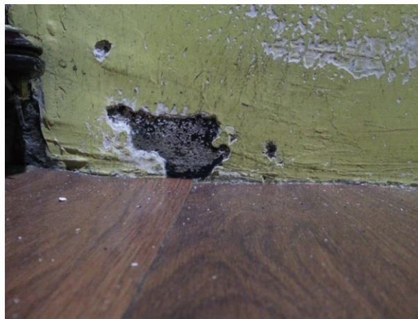
■樓層接縫施工不良，長期滲水潮濕引發壁癌。
