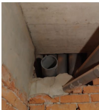
■ 管道間接管處未妥善密封，容易造成管道內廢氣擴散至室內。
