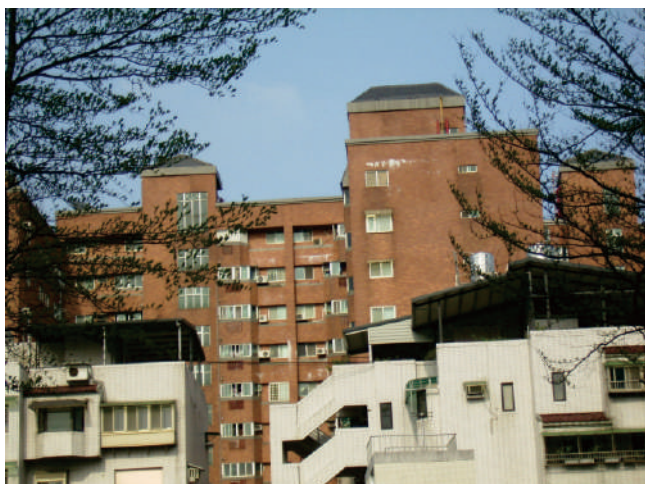
■ 大樓外牆產生白華不僅影響美觀，嚴重時還可能造成鋼筋鏽蝕損害整體大樓結構。
