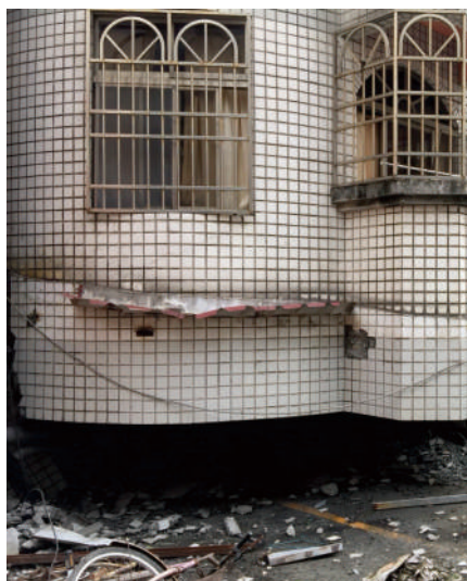
■ 左圖：花蓮地震倒塌的白金雙星大樓（右側）一樓設置停車空間，當大地震來襲時，容易造成軟腳建築而倒塌。圖中可以看到有汽車停在一樓被大樓壓毀。
