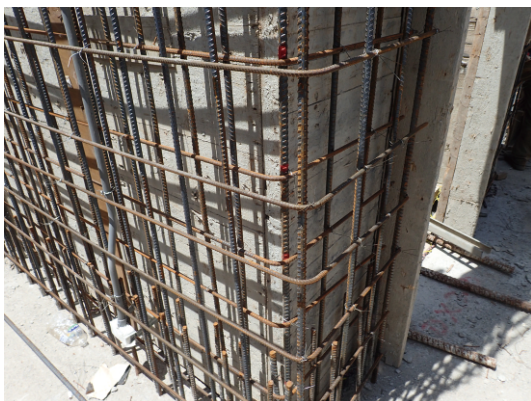
●未依結構標準圖說施作之牆轉角鋼筋。
