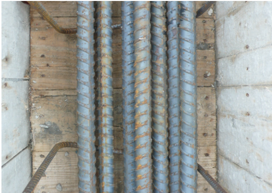
●梁底鋼筋設計不當，造成梁筋過密重疊，混凝土無法充分包覆每一支梁筋，無法發揮應有之握裹力，不符合設計需求。
